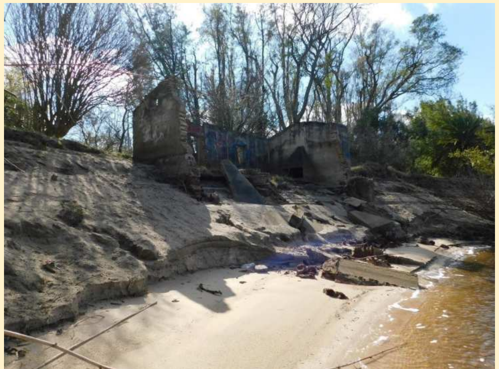
Además del derrumbe que va sufriendo la casa, es notorio como el agua ha ido erosionando el terreno, habiéndose llevado ya varios metros del mismo.
