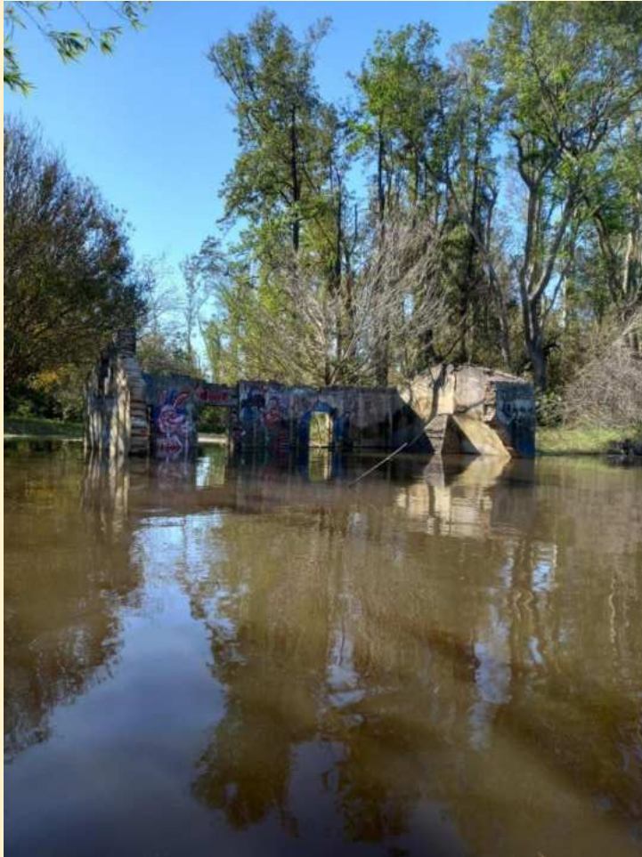
En esta imagen, podemos apreciar la casa que supo ser el hogar de Juan Aguiar y María Estrella, afectada por las inundaciones de mayo 2024, habiendo ya caído una de las paredes
