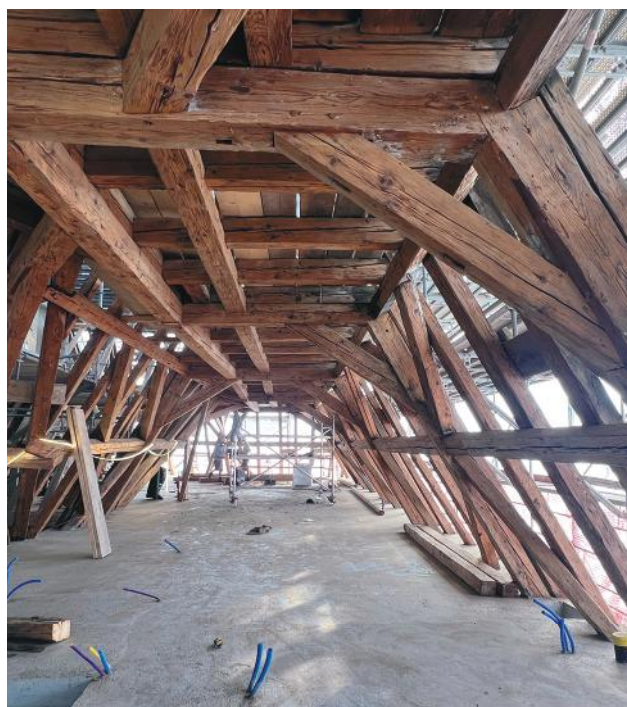
Les archives communales se retrouveront sous la magnifique charpente des combles du bâtiment no 183.
