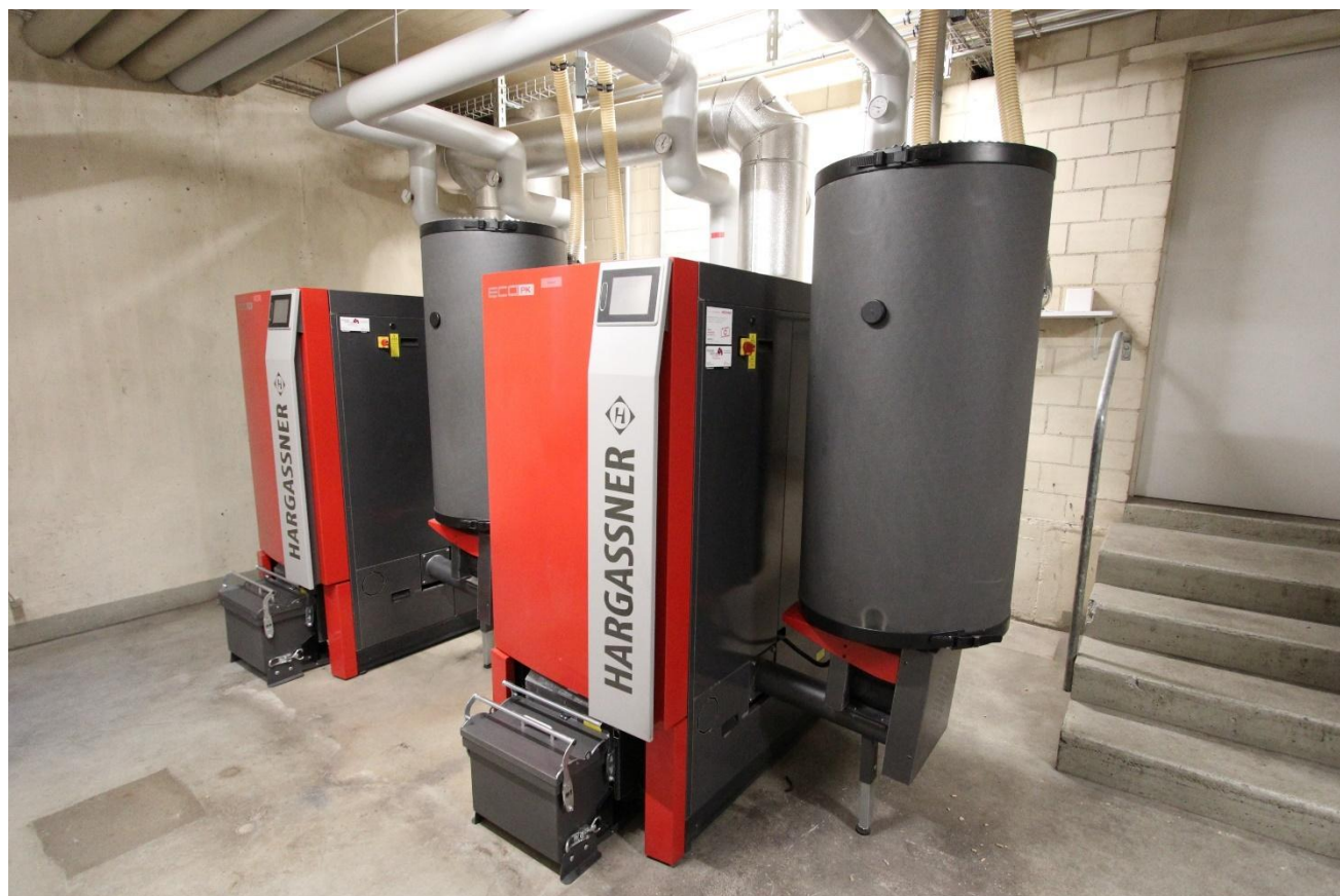
Pelletheizung für Überbauung in Gettnau, 2 x 90kW, Heizmann AG
