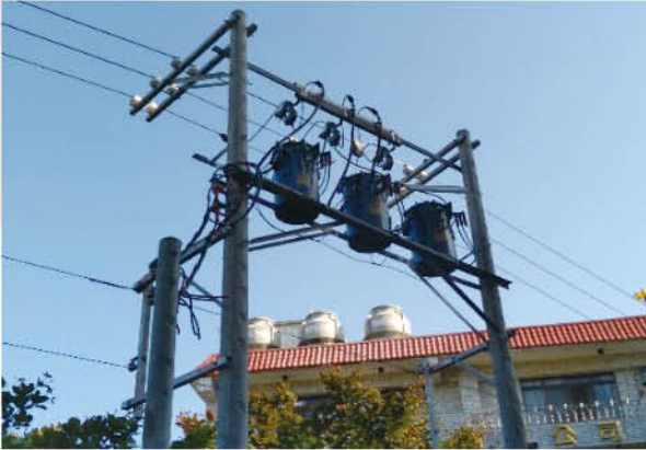
電線桿上的變壓器
