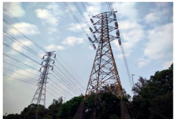
■ 高壓電塔及傳輸線
