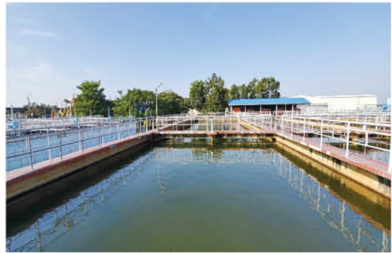
■ 淨水場內的水池
