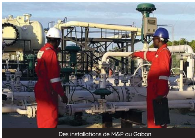
Des installations de M&P au Gabon
