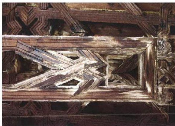
Fig. 19: Filtraciones de agua en tirante. Imagen cedida por Luis Anselmo Ibáñez Calero, arquitecto responsable del proyecto de restauración del año 2009.
