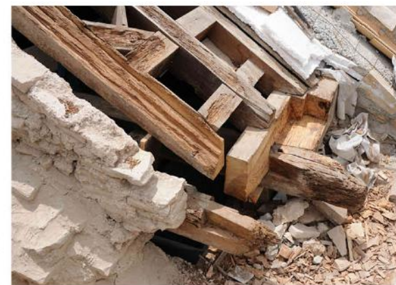
Fig. 21: Disgregación de la madera en el encuentro del artesonado de par y nudillo con el muro (derecha) y con el primer arco (izquierda). Imagen cedida por Luis Anselmo Ibáñez Calero, arquitecto responsable del proyecto de restauración del año 2009.
