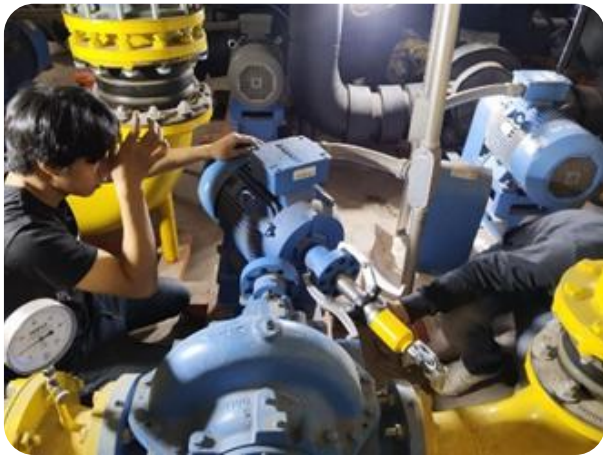
การบำรุงรักษาระบบผลิตน้ำเย็น (Chiller Plant)
