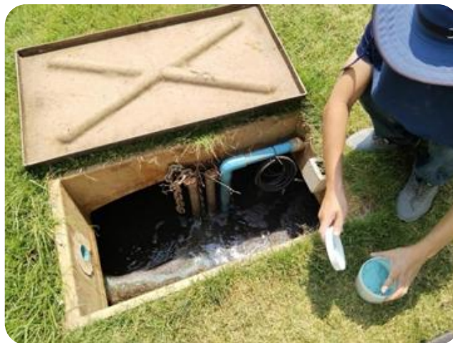
การบำรุงรักษาระบบบำบัดน้ำเสีย
