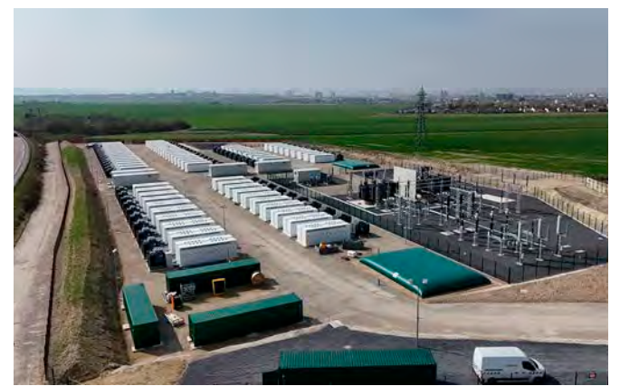
Le site est équipé de 140 unités de stockage Tesla Megapack. © TagEnergy
