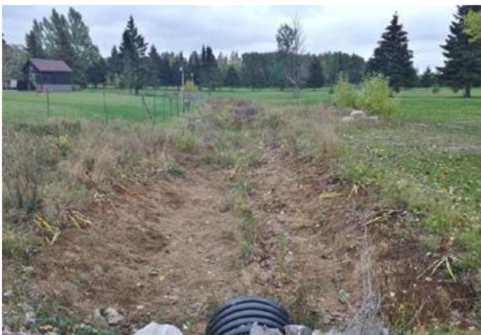
Bassin de biorétention aménagé au Golf Domaine Lac-Saint-Jean de Saint-Prime dans le cadre du projet. (© Vincent Chartier)
