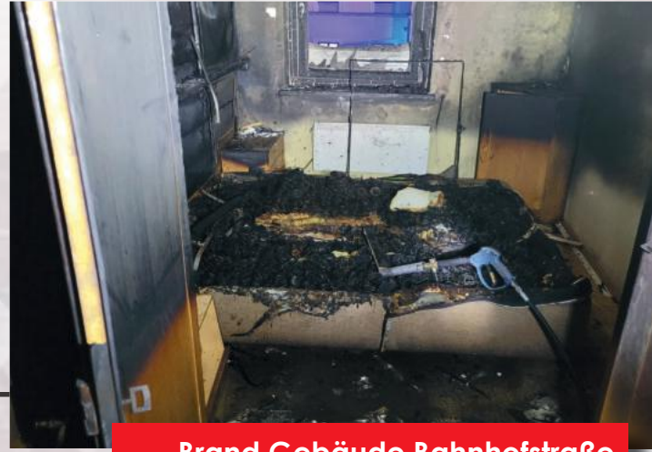
Brand Gebäude Bahnhofstraße
