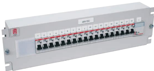
Panel PS-3U wyposażony w wyłączniki instalacyjne 48 V
