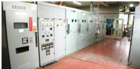
Extinction d'incendie pour salle électrique usine
