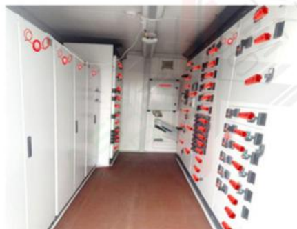
Extinction d'incendie pour salle électrique
