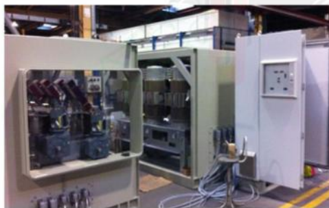
Extinction d'incendie pour armoire d'automatisme et contrôle
