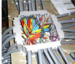
Extinction d'incendie pour boîte de jonction dans les combles
