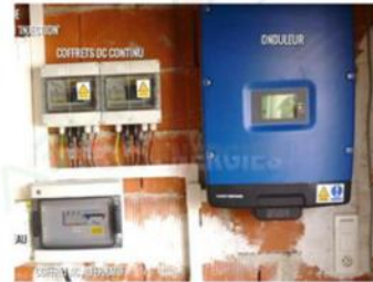
Extinction d'incendie pour coffret DC / AC raccordement panneaux photovoltaïque
