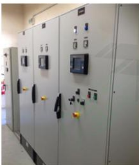
Extinction d'incendie pour armoire de contrôle
