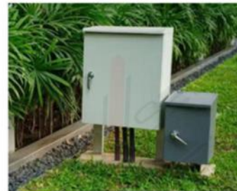
Extinction d'incendie pour coffret électrique extérieur
