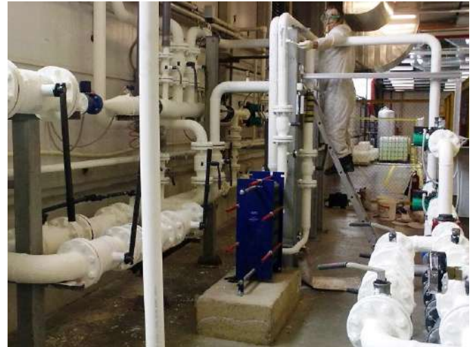
AISLACION DE LINEA DE VAPOR
