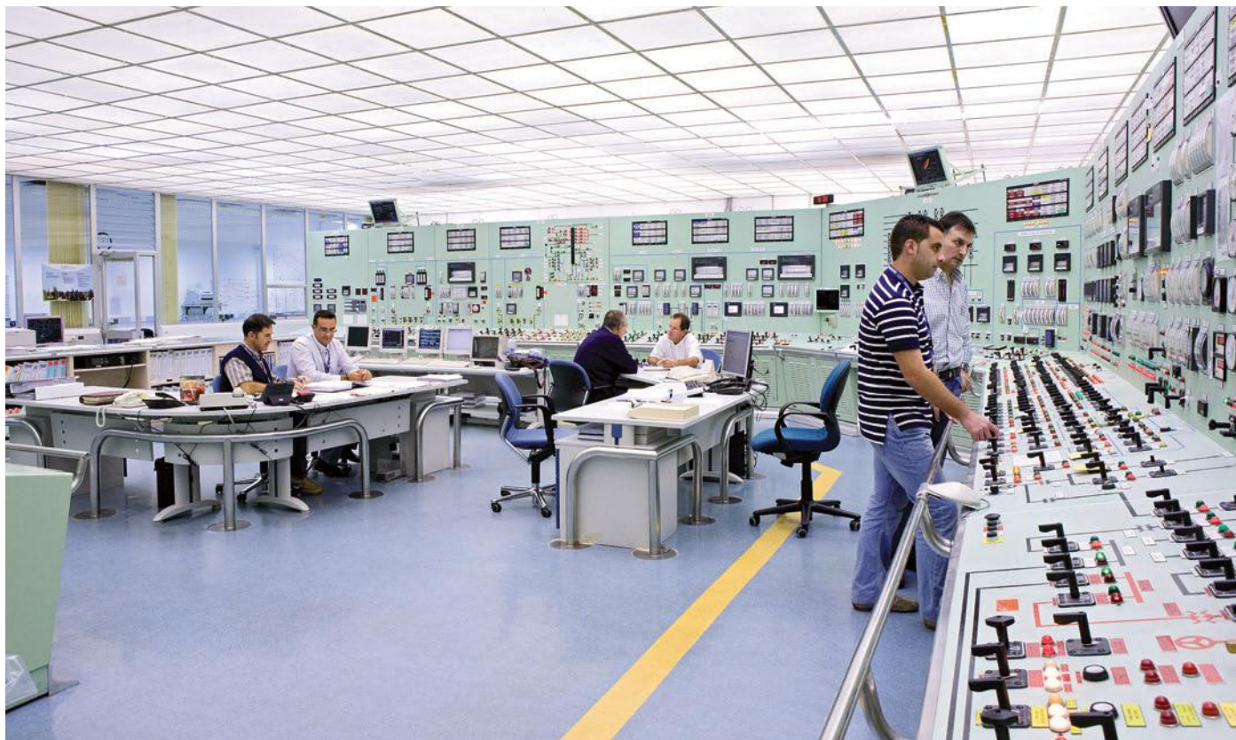
Garoiako Santa Maria zentral nuklearraren kontrol-sala. Zentrala Espainiako zaharrena da, eta Fukushimakoaren mota berekoa. ARG.: GAROÑAKO SANTA MARIA.
