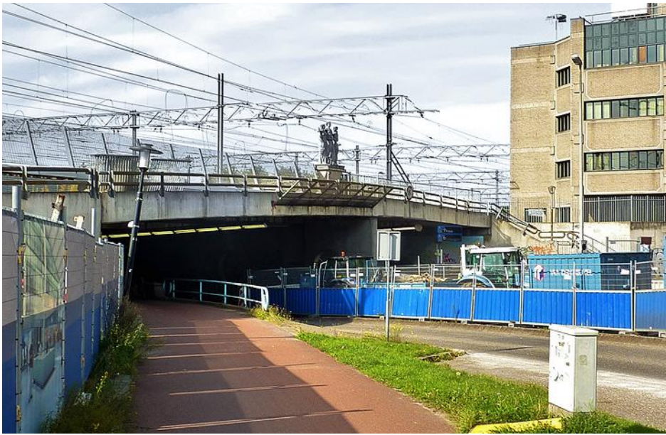
1 De Leidseveertunnel anno 2013: een deplorabel geval
