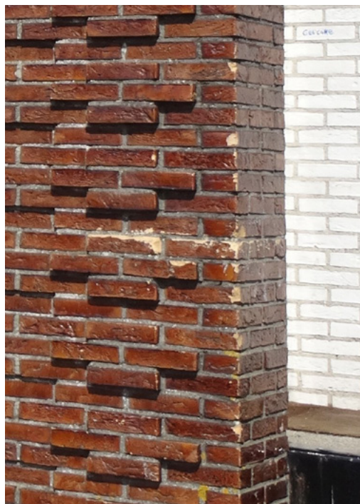
Afb. 5.33 Beschadigingen aan het glazuur op de zuidoostelijke hoek.
