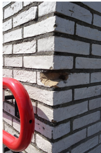
Afb. 5.28 Ernstig beschadigd metselwerk op de zuidoosthoek.
