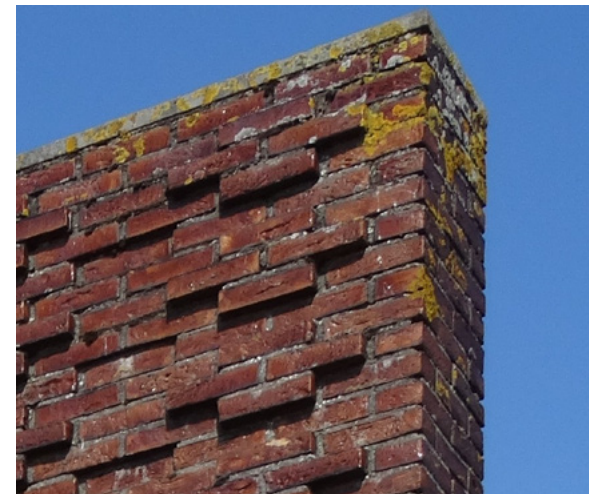
Afb. 5.34 Verwering van het glazuur langs de bovenzijde aan de zuid en zuidoostzijde.
