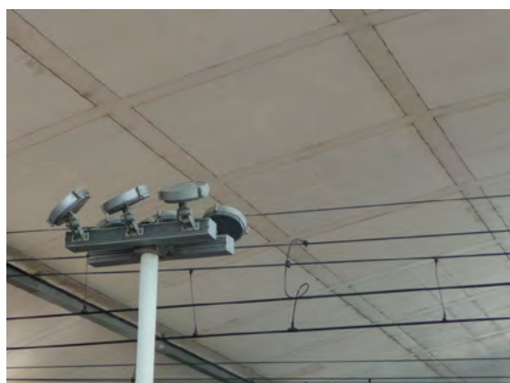
Vernieuwde spots onder de stationskap.
