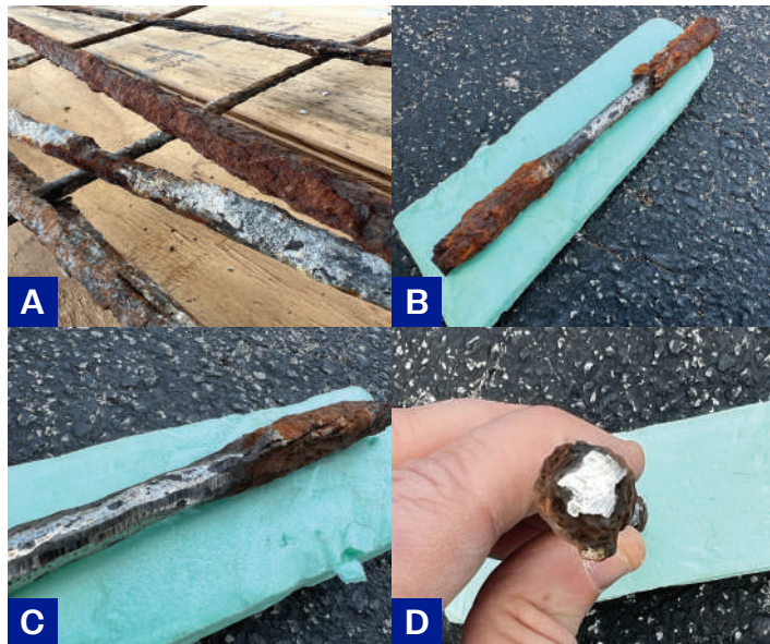
Fig. 2: Ejemplos de: (a) corrosión inducida por cloruro y óxido en barras de acero de refuerzo; (b) sección de la barra con productos de corrosión (óxido) retirados de la porción media con una rueda de esmerilado; (c) diferentes productos de corrosión expansivo con color y picaduras con productos de corrosión; y (d) sección transversal al final de barra que muestra corrosión en forma de deterioro significativo y pérdida de sección de la barra.
