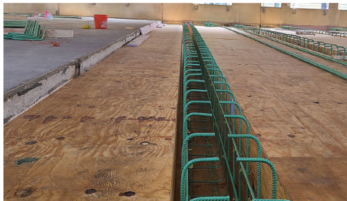
Detalle parcial de la barra de refuerzo con reparación moldeada
