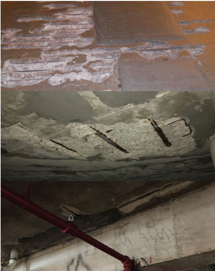
Fig. 4: Ejemplos de deterioro relacionado con la corrosión adyacente a las áreas de reparación.
