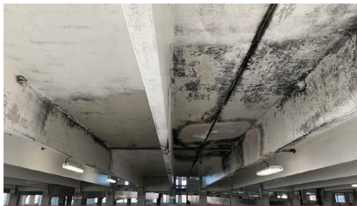
Daño por fuego en la parte inferior de las vigas dobles pretensadas de nivel cuatro
