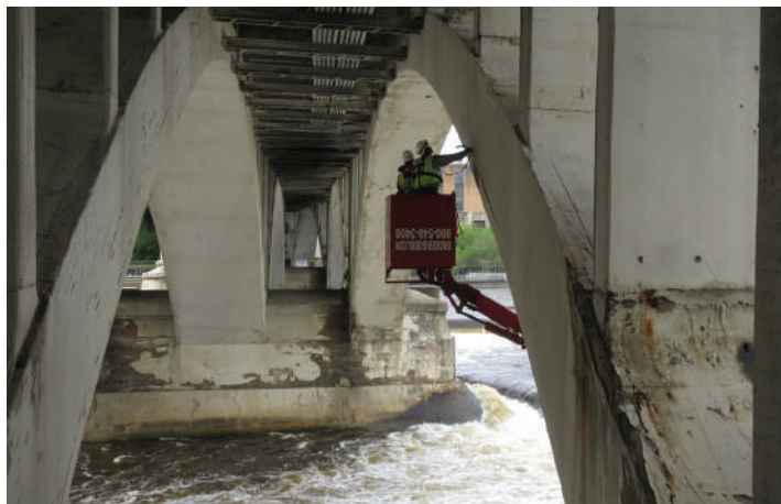
Inspección manual desde una unidad de inspección bajo el puente, mostrando el deterioro de las costillas del arco y las bases de los pilares
