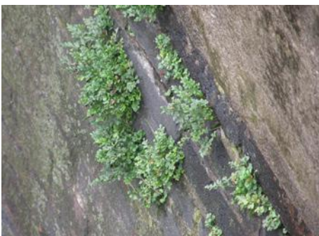
Muurvaren op een oude kerkmuur
