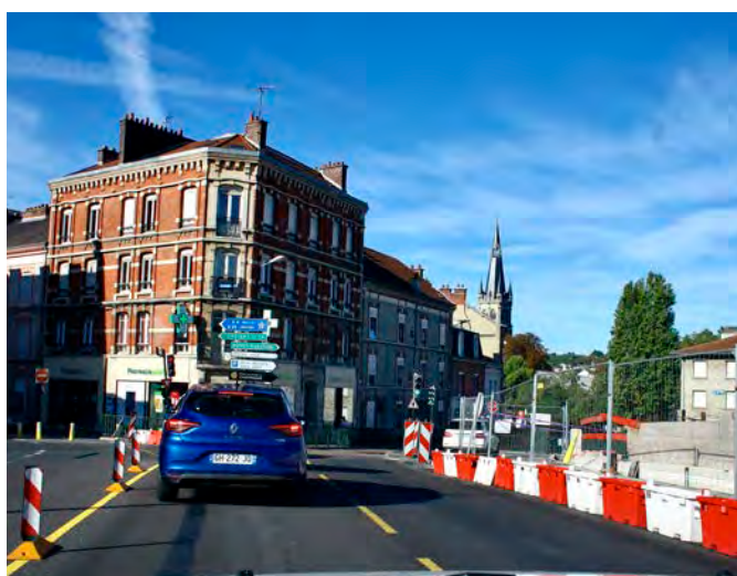
Le trottoir qui « regarde » vers la gare d'Épernay restera inaccessible jusqu'en décembre. © l'Hebdo du Vendredi
