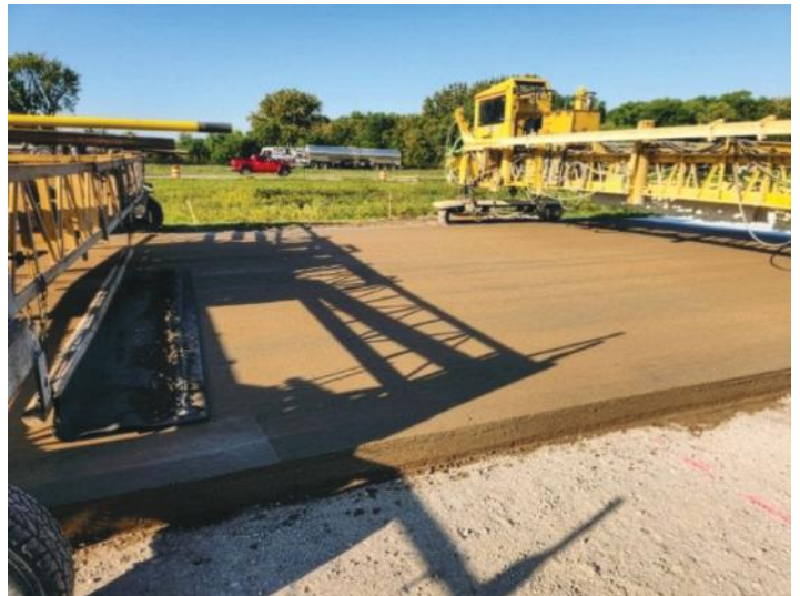
Fig. 2: La sección de prueba 2401 de MnROAD se colocó el 9 de septiembre del 2024. El material cementante Estaba compuesto por una mezcla de 50% de cemento Tipo IL (15% de caliza), 30% de arcilla calcinada y 5% de yeso (contenido total de 570 lb/yd 3 )
