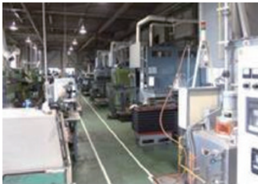
Figura 38 Línea de tratamiento térmico
