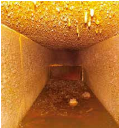
Dutos com gordura
