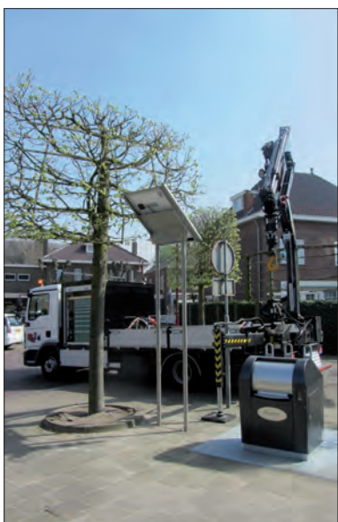
Service aan Solar perscontainer.
