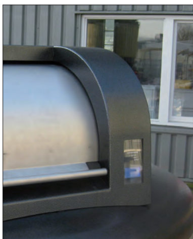
Toegangscontrole op semi-ondergrondse afvalcontainer.
