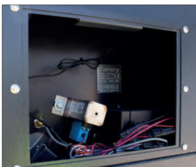
Binnenwerk van de toegangscontrole bij de Sentry.
