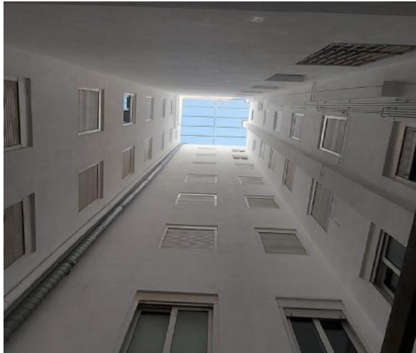
OBRA: Reparació i pintura de pati de llums SITUACIÓ: Av, Lluís Pericot 68 - Girona ANY: 2019
