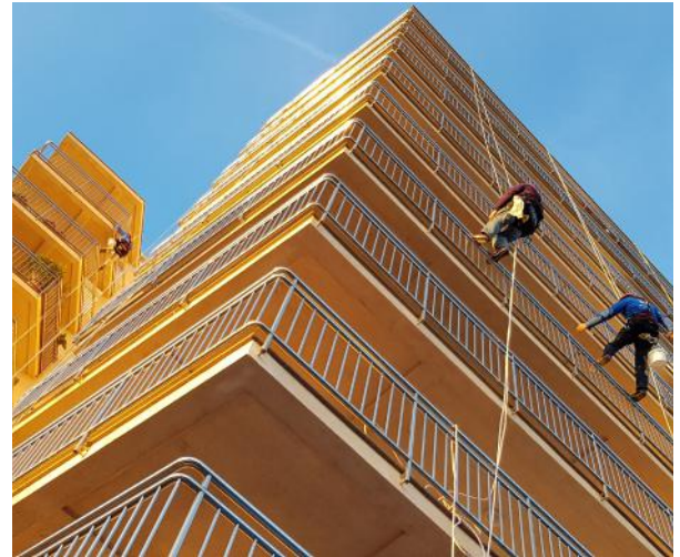
OBRA: Rehabilitació façana a l'edifici CAP DUCAL SITUACIÓ: St. Feliu de Guíxols - Girona ANY: 2008
