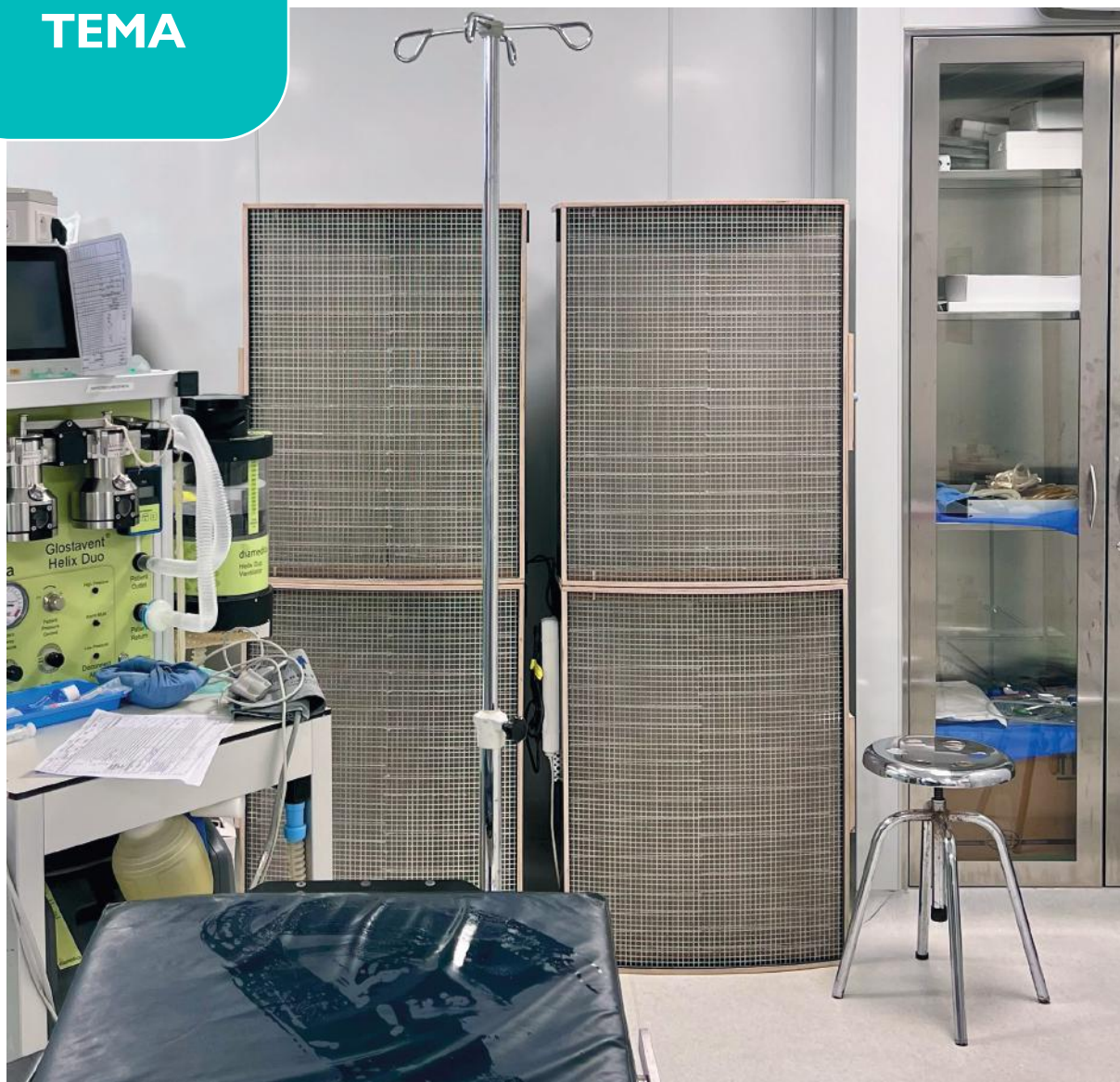
Bild 3, den temporära installationen av luftrenarna (stående på golvet) i salen på Panzi-sjukhuset.
