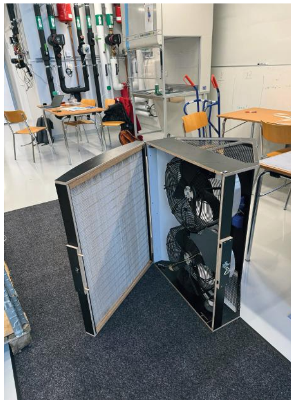
Bild 1, luftrenare med fläktar och lamellbyggt filter.
