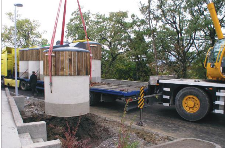
Einbau von Tièrso-Systemen in Gap (Frankreich); nach dem Verfüllen der Baugrube ist das System einsatzbereit.
