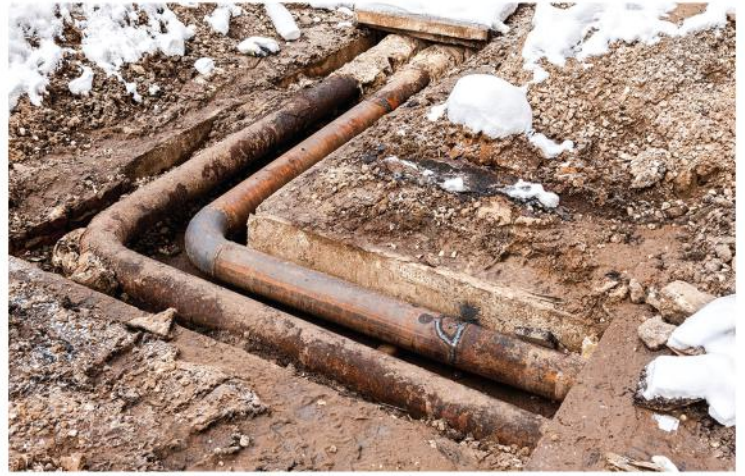
STEEL UNDERGROUND CONDUITS
