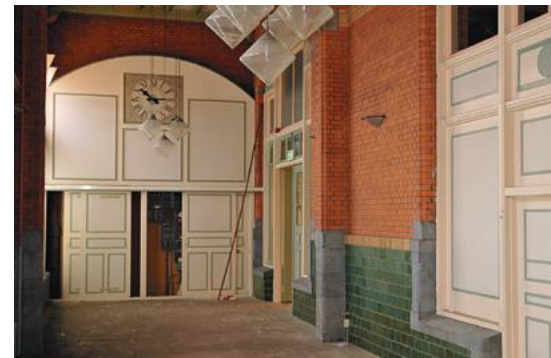
Verbindingsgang, dichtgezet, tussen hoofdingang en voormalige visitatiehal. Rechts de deuren naar de voormalige wachtkamers. Een originele tegelklok is verplaatst naar de tussenwand. (foto 2013)
