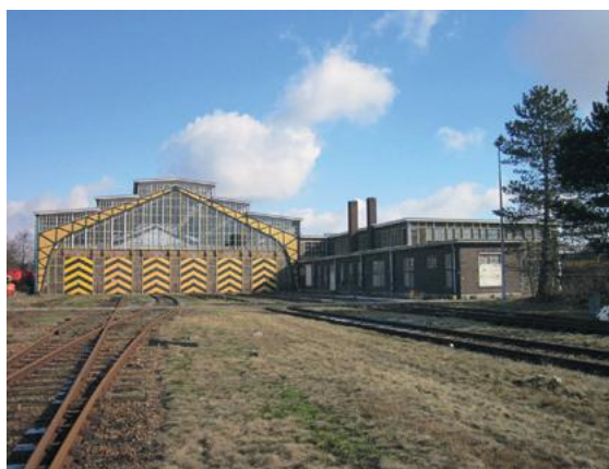
Front van de Locomotievenloods. Op het dak zijn de ontluchtingskanalen van de rookkappen verwijderd. Rechts de kantorenvleugel, 2013
