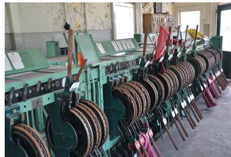
Interieur van de seinzaal van het seinhuys, met de handels voor de bediening van de seinen en wissels (niet meer in gebruik) (2010, Pro Rail)
