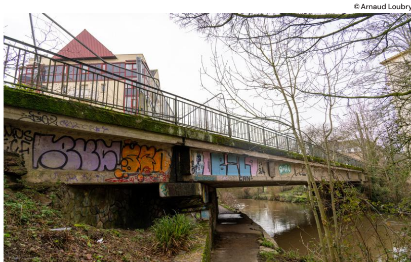
↑ Vétuste, le pont Papu est fermé à la circulation depuis 2023.
