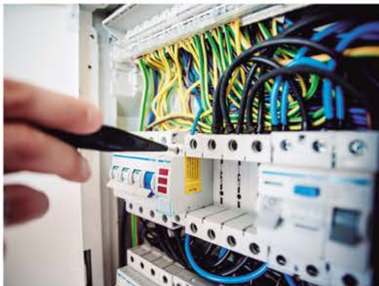
■ Fiação irregular causa risco de incêndio e eleva os custos da conta de luz
