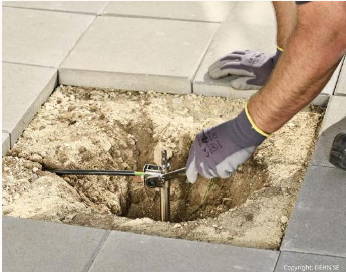
Erdungsanlagen mit Tieferdern sind die ideale Lösung für Bestandsgebäude – mit oder ohne Keller.
