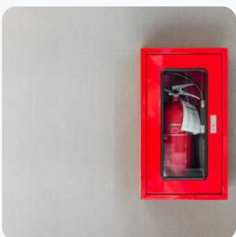
ถังดับเพลิงทุกหอ
