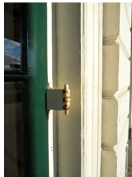
Afb. 5.3.9 Originele scharnier aan een perrondeur in de westvleugel van Harlingen.
