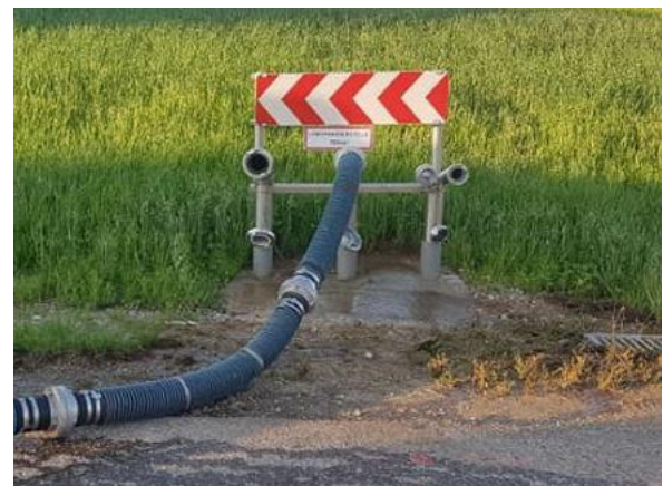
Foto FF-Fornach: Löschwasserbehälter ( https://www.ff-fornach.at )
