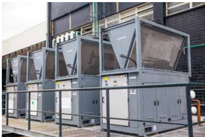
Figura 2: Chillers para sistemas de refrigeração remoto (Eletro frio Refrigeração)
