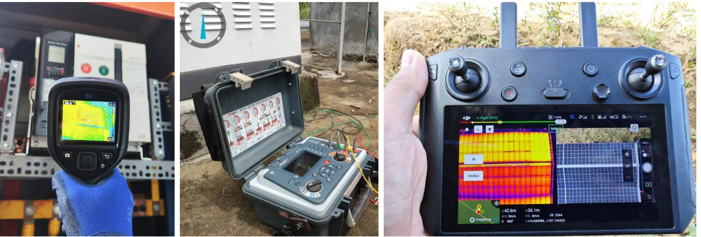
Cụm nhà máy Chư Sê - Kiểm tra giá trị điện trở chống sét TBA
