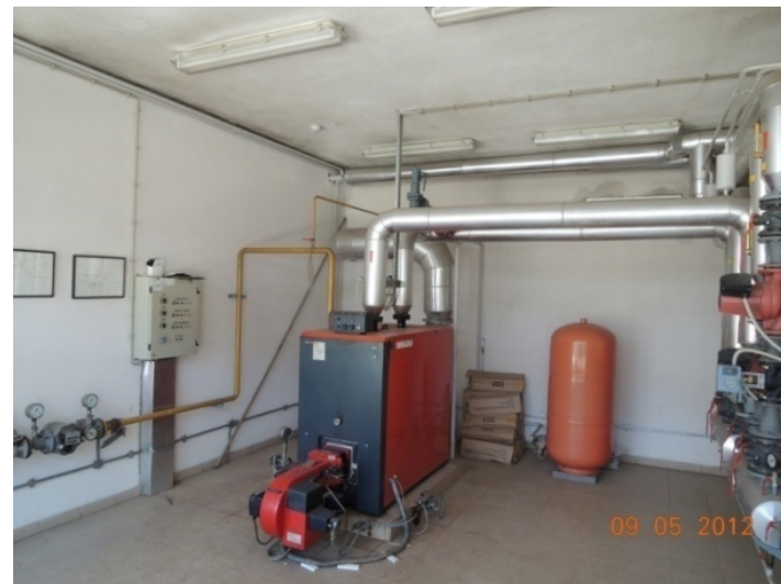
Fotografija 8.54. Zgrada JU OŠ Skender Kulenović u Sarajevu, kotlovnica (09.05.2012.)
