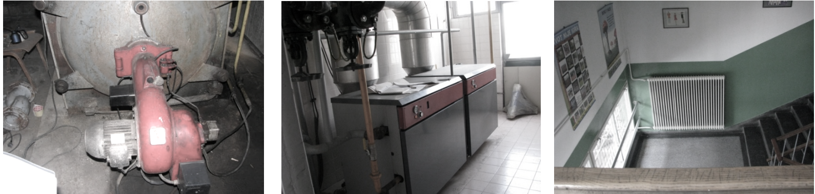
Fotografija 8.43. Zgrada JU OŠ Hasan Kikić u Sarajevu, (a) sekundarna kotlovnica, (b) primarna kotlovnica (24.02.2010.)
