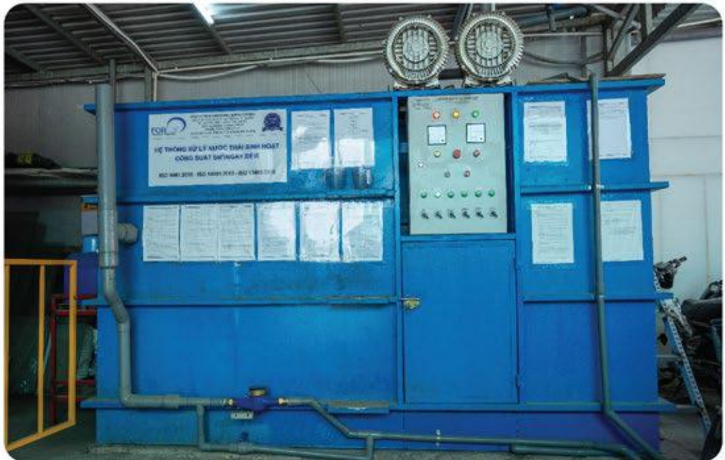
* Hệ thống xử lý nước thải. Wastewater treatment system.
