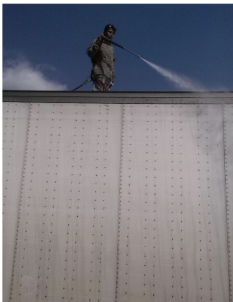
Fig. 1.3 Reparación de una caja seca después del resultado de la prueba de agua (parte lateral)
