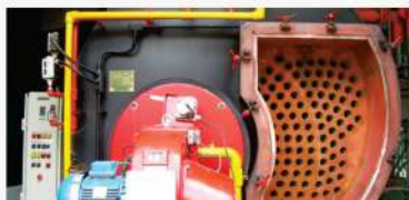
Control de Recipientes a Presión - Calderas
