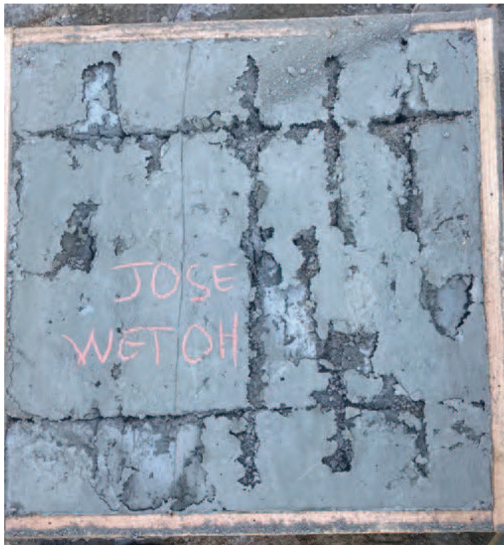
Figura 4: Panel con lanzado hacia arriba con sobredosis de acelerante durante la colocación. Cuando el concreto golpea el panel fragua inmediatamente, lo que no permite el flujo del concreto alrededor de las barras de refuerzo, lo que ocasiona huecos y vacíos atrás.
