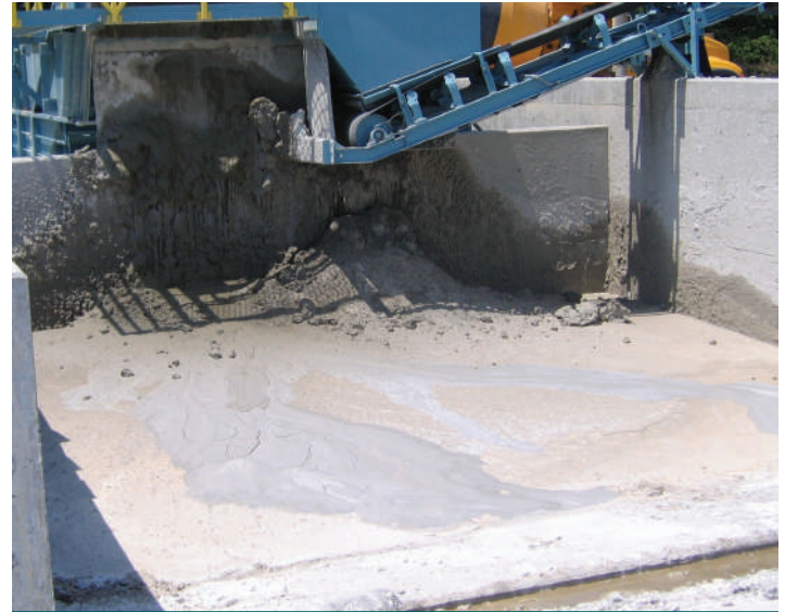
Tolva de almacenamiento de sólidos de cemento recuperados en el sistema JADAIR Redi-Wash.
