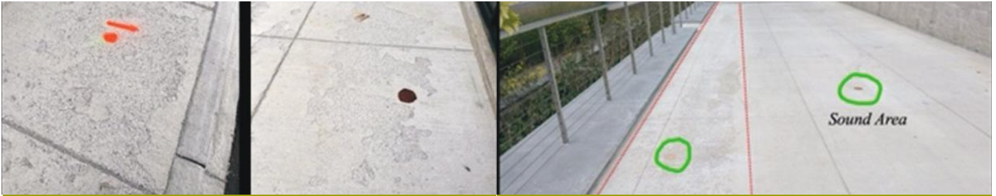
Caso 1: Descamación en cemento Tipo IL + SCM (20% de ceniza volante clase F), relación agua/cemento 0.45, 6% de aire, mezcla de 4,000 psi. Acera sobre el terreno, Louisville, KY, EE.UU.
