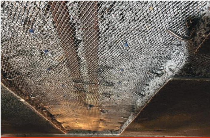
Fig. 4: El techo del viaducto está construido con una losa de concreto con carbonilla suspendida y reforzada con malla metálica. La malla metálica dañada se sustituyó por material nuevo para restablecer la continuidad de la carga (foto cortesía de Thornton Tomasetti)
