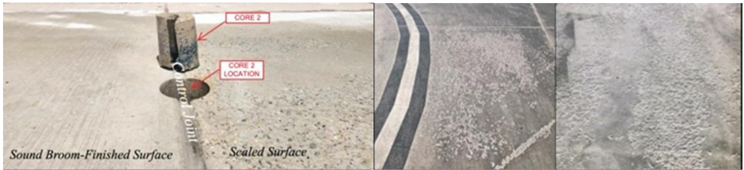
Caso 3: Descamación en cemento Tipo IL + SCM (35% de escoria), a/cm de 0.45, 7% de aire, mezcla de 3,500 psi. Losa sobre el terreno, Michigan, EE.UU.
