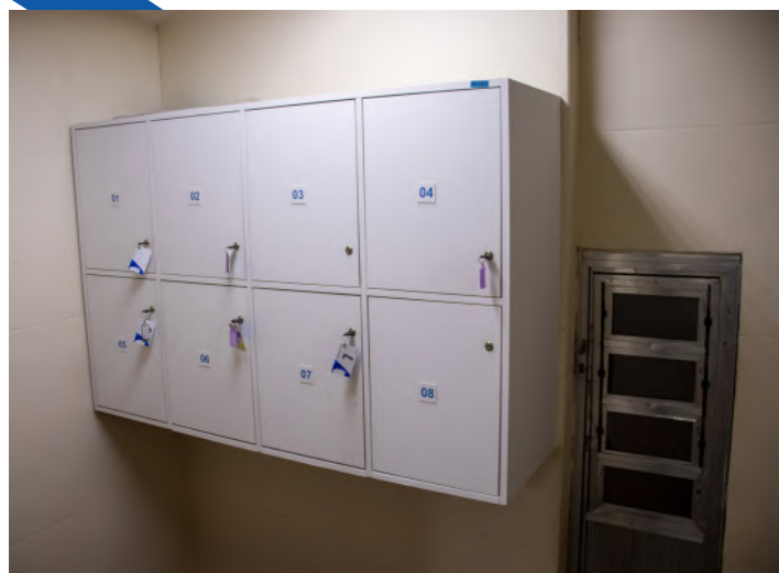
Imagem do armário - Localização térreo - Deteriorado
