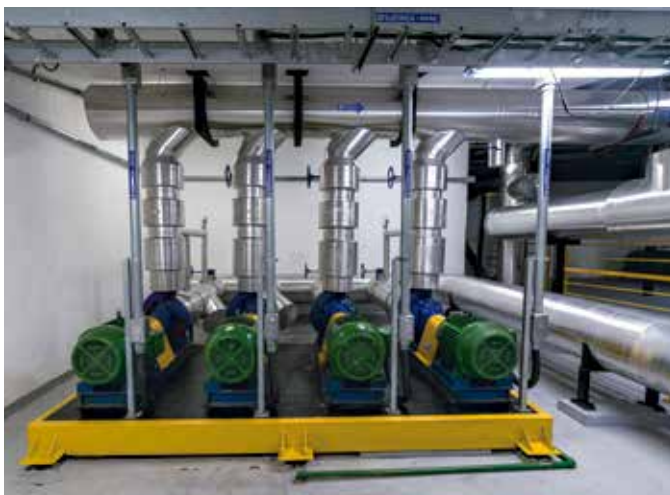
Central de água gelada
