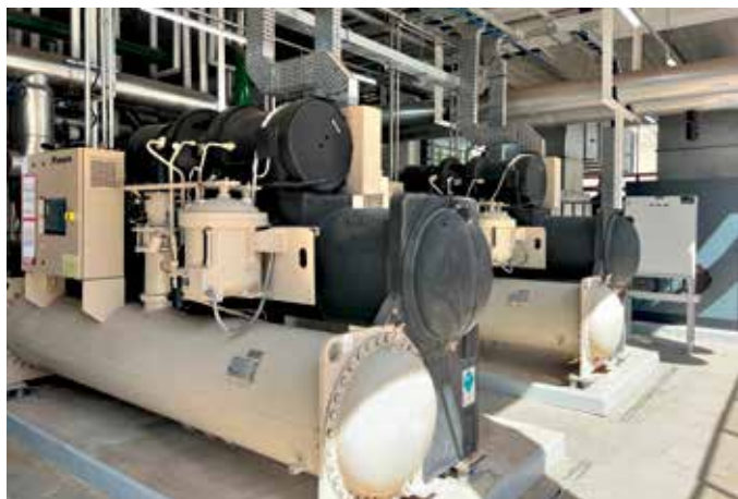
Central de água gelada
