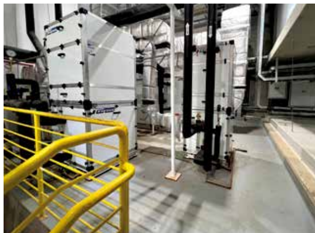
Tratamento de ar
