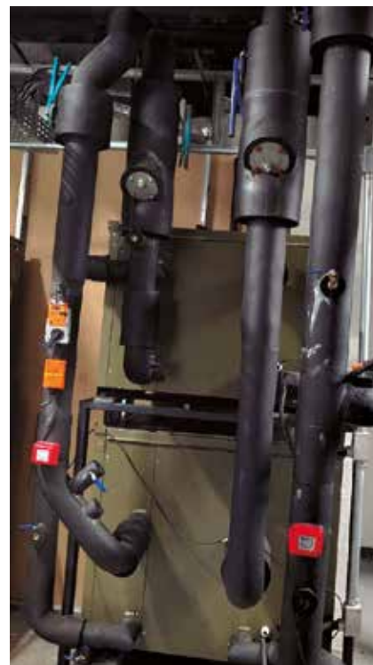
Bombas de calor água- água
