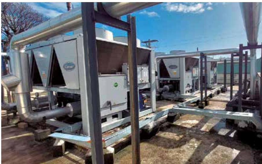
Central de água gelada
