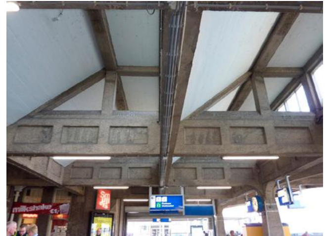
Sheddaken in de perronkap van het kopperron ter hoogte van de doorgang.
