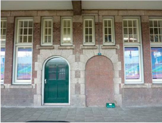
Perrongevel ter hoogte van de fietsenstalling. De doorgangen waren voorheen bedoeld voor de toegang naar de toiletten.
