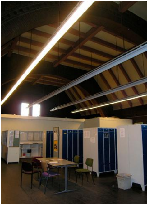
Originele plafond van de visitatiezaal (foto genomen op de tussenverdieping van de dichtgezette vide). [J.Ruland]
