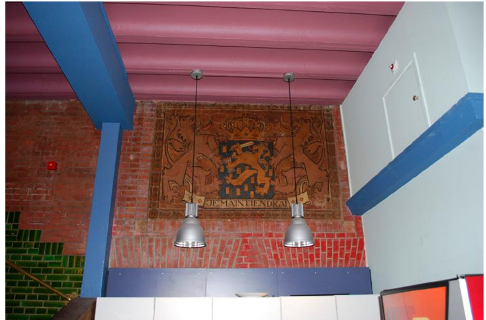
Origineel metselwerk, verglaasde baksteen en tegeltableau met wapen van Holland. Blauw en lila zijn de onderdelen van de niet-originele tussenverdieping. [J.Ruland]
