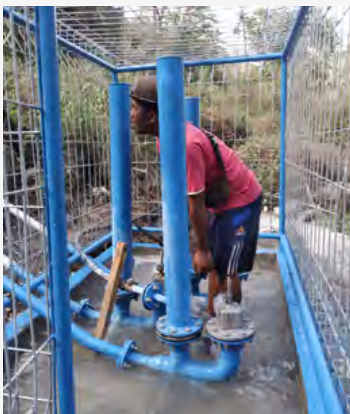
Pompa Hydrant dan perpipaan dari mata air ke rumah warga
