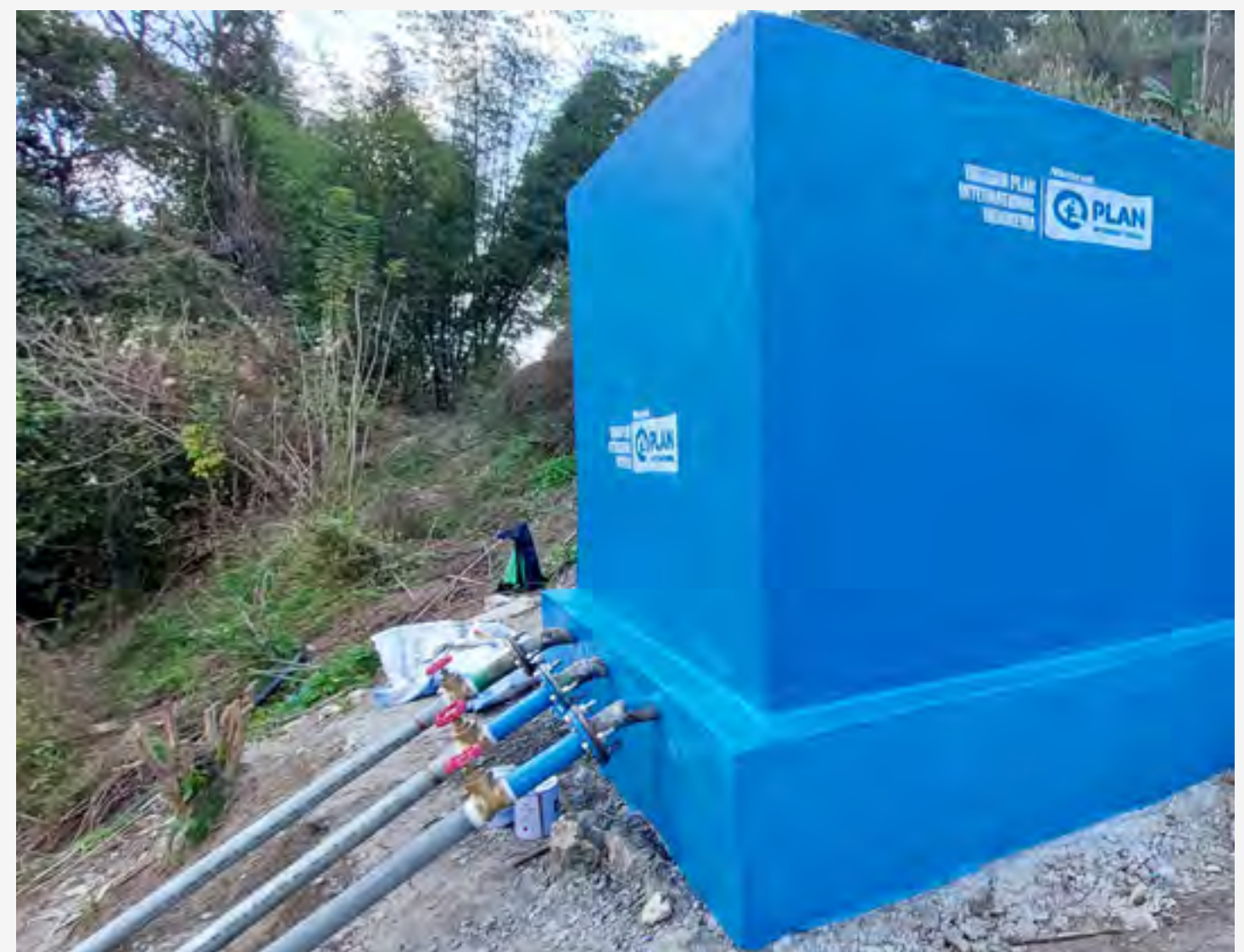
Bak penampungan sementara sebelum air dialirkan ke rumah warga
