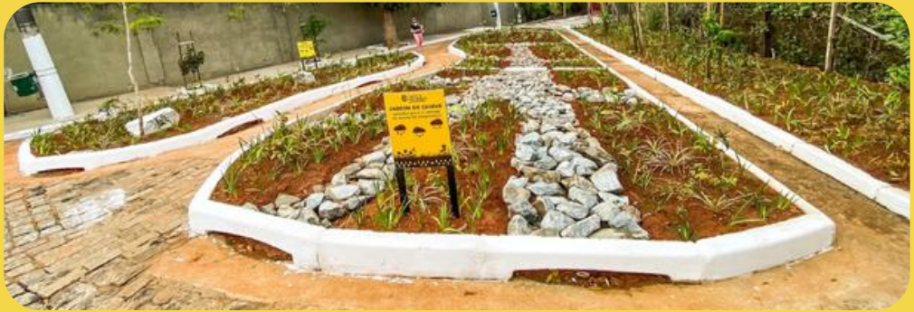
Ejemplo de jardines de lluvia en la ciudad. Imagen: Prefeitura de São Paulo.
