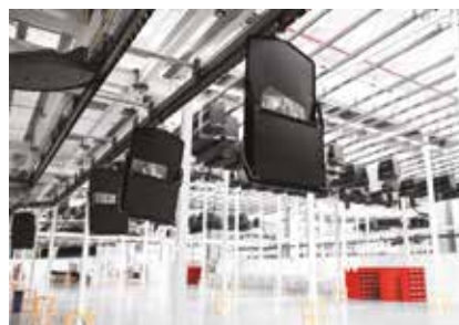
Das leistungsstarke Überkopf-Taschensystem ferag.skyfall vereint die Funktionen Fördern, Puffern, Sortieren, Kommissionieren und Versandvorbereitung in einer einzigen Anlage.
