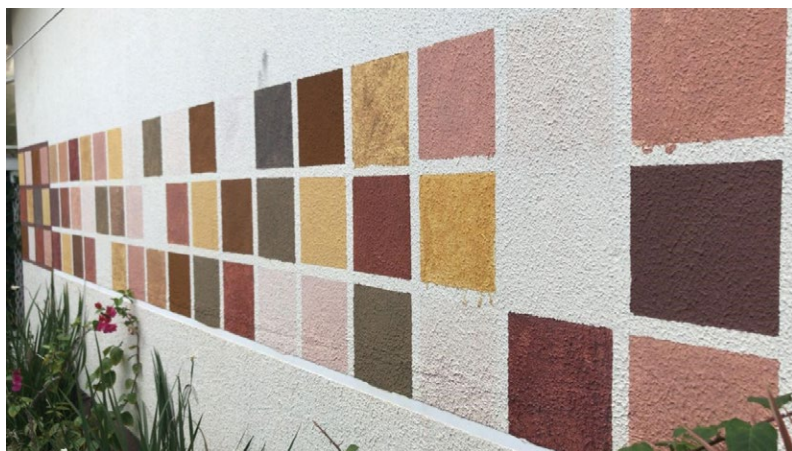
Figura 6. Estado atual de uma parede pintada experimentalmente há 4 anos. Fonte: Autores (2021).
